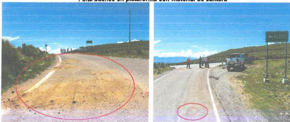
Falta bacheo en plataforma con material de cantera
