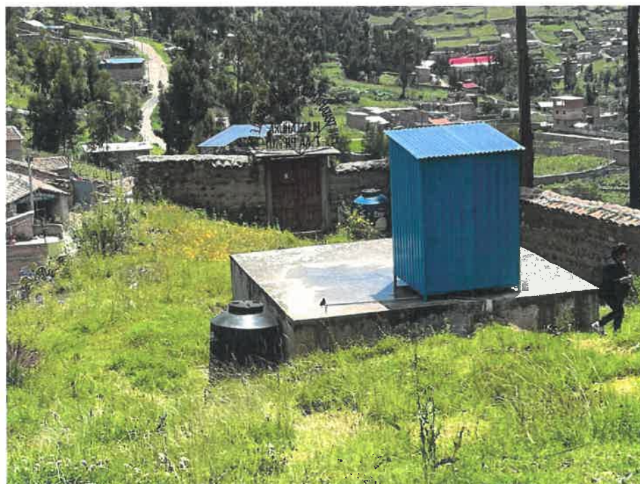
Caseta de cloración y tapa del reservorio del sistema de tratamiento de agua (filtración y Reservorio) del centro poblado de Huasachura.
