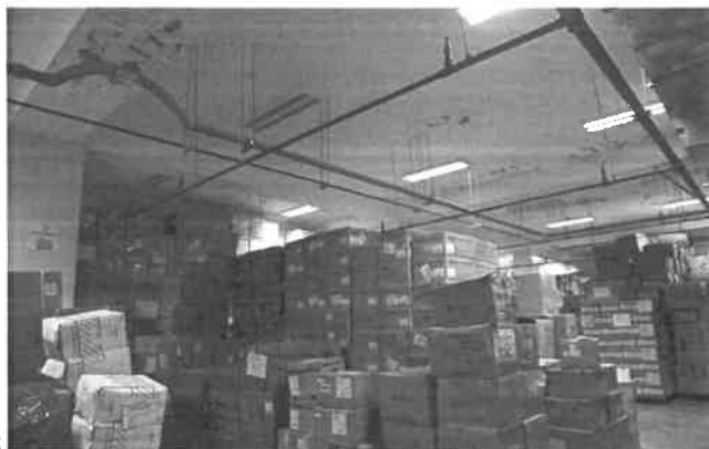
CAJAS ARRUMADAS QUE NO PERMITE SU ORDENAMIENTO POR LAS FILTRACIONES.
