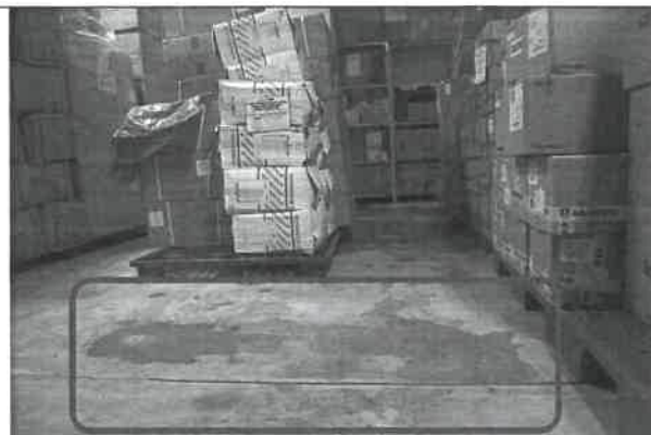
CHARCOS DE AGUA AL INTERIOR DEL ALMACÉN.
