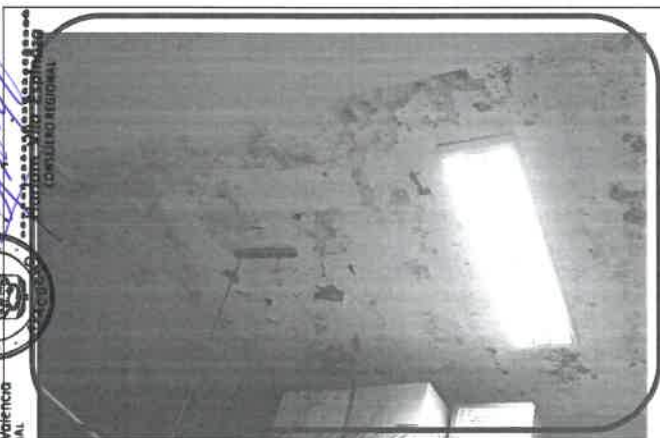
SE APRECIA EN EL TECHO FILTRACIONES, CAÍDA DE MATERIALES EN CUBIERTAS
