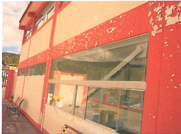
Parte frontal interna de ingreso a I.E. se observa en la pared el descascamiento de la pintura, producto de las lluvias y humedad.
