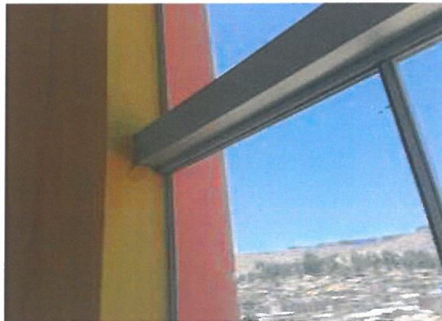
Vistas fotográficas de las ventanas con deficiente acabado de derrame con desprendimiento del acabado de los módulos N° 3 v 4.
