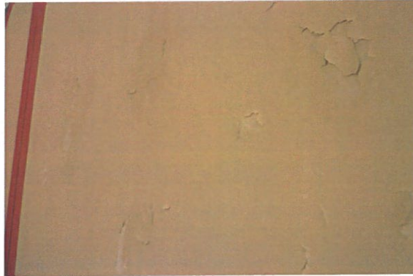
Vistas fotográficas del descascaramiento de pinturas, producto de lluvias y la humedad constante.
