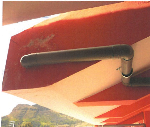
Vistas fotográficas donde se puede apreciar tubo de drenaje averiado que ocasiona goteras de agua y humedad en las paredes, producto de las lluvias y la humedad constante.
