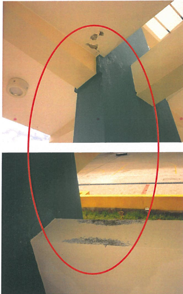
Vistas fotográficas de la Rampa, los mismos que se observó filtración de agua en las juntas del techo, que viene afectando las estructuras producto de lluvias y la humedad constante.
