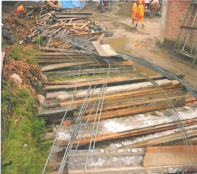
Inadecuado almacenamiento de fierros de construcción y tubos de desagüe.
