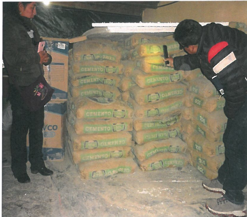
Inadecuado almacenamiento de cemento.
