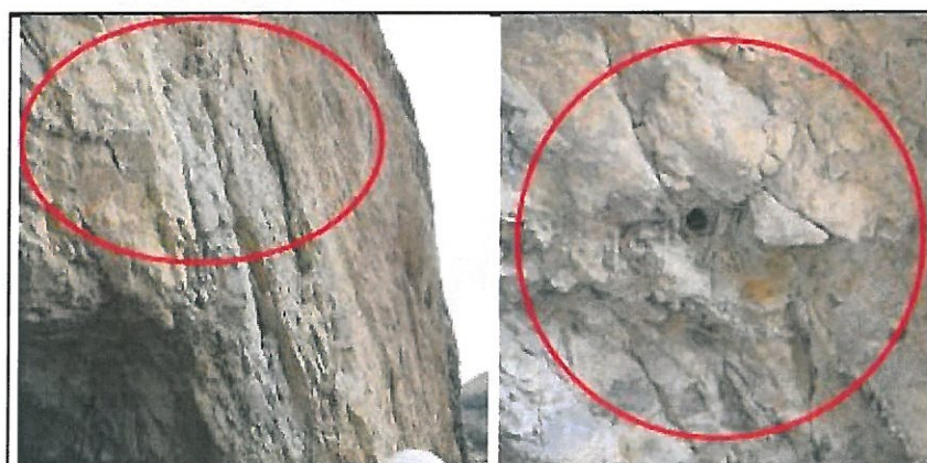
Rocas fracturadas en el acceso del Túnel N° 01.
