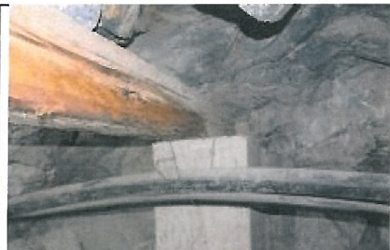
Tuberías de agua y aire sin señalización
