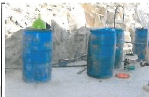
Cilindros de combustible sin rotulado y sin bandeja de contención
