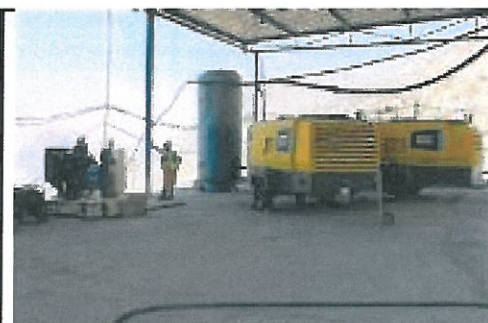
Casa Compresora sin Kits anti derrame y equipos sin bandeja de contención
