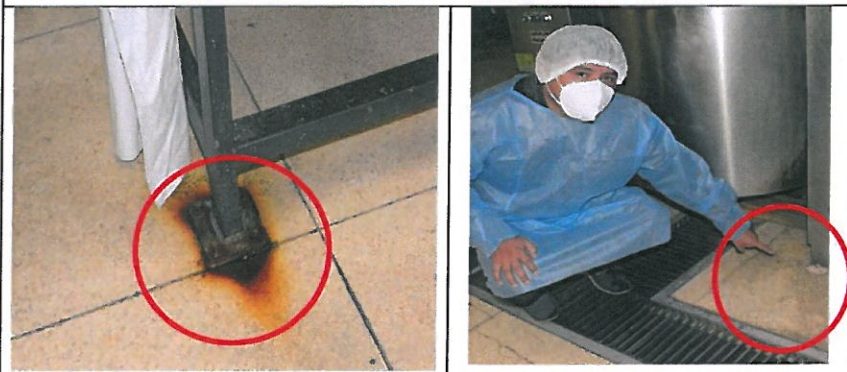
Infraestructura con presencia de óxidos
