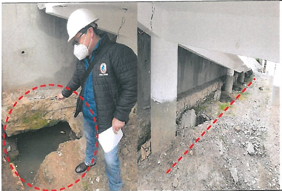
IMG. N°01.- Durante la visita a obra se pudo evidenciar empozamientos de agua ubicados debajo de la rampa de acceso entre el patio de formación y el Módulo A, posible nivel freático debido a la ubicación del proyecto en zonas de afloramiento de aguas subterráneas, persistentes a la fecha pese a la construcción de un canal de concreto perimetral a la edificación, sistemas de drenaje de aguas superficiales y subdrenes (falta complementar) para evacuar las aguas subterráneas. Situación que podría derivar en el asentamiento de parte de la estructura.
