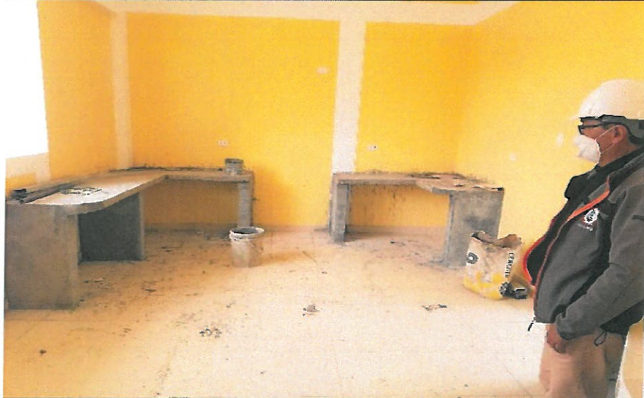
IMG. N°06.- Trabajos complementarios propuesto por los ejecutores en los ambientes de la cocina, generadores de adicionales de obra por su construcción, cortes en piso y paredes, reposición del porcelanato para la instalación del sistema sanitario, además del repintado de todo el ambiente, y que consecuentemente generarían incrementos presupuestales de obra.
