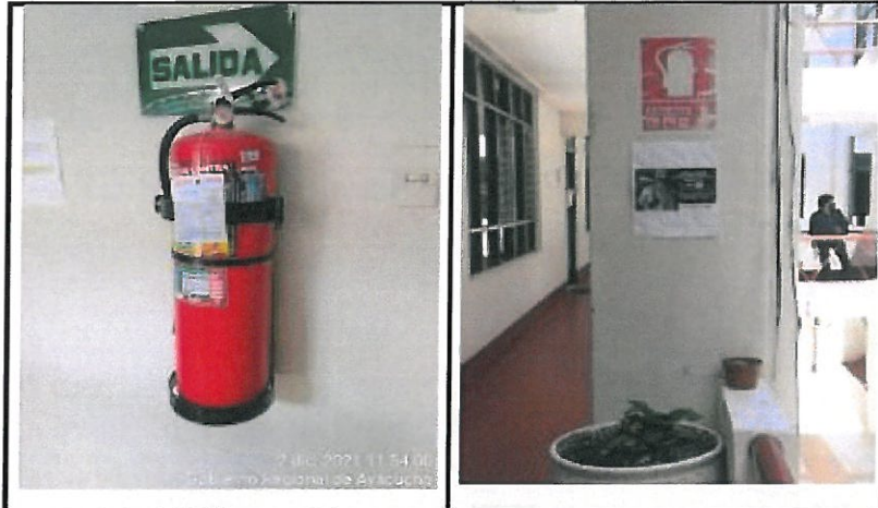
La sede principal del Gobierno Regional de Ayacucho, no cuenta con la distribución y equipamiento de extintores en los diversos niveles.
