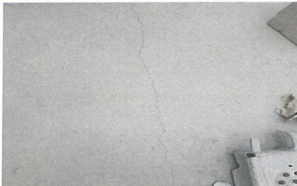
Imagen 03: Se observa las rajaduras pronunciadas en el piso.
