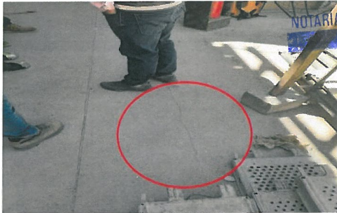
Imagen 04: Se observa que debajo de la junta sobre sale una rajadura horizontal muy pronunciada, que podría tratarse por asentamiento del piso o mala compactación
