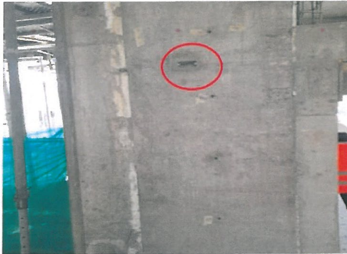
Imagen 05: Se observa una caja rectangular de luz, colocada en una columna portante.
