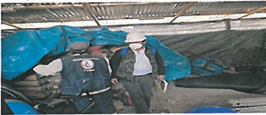
Imagen 10: Se observa la verificación de las bolsas de cemento en mal estado.
