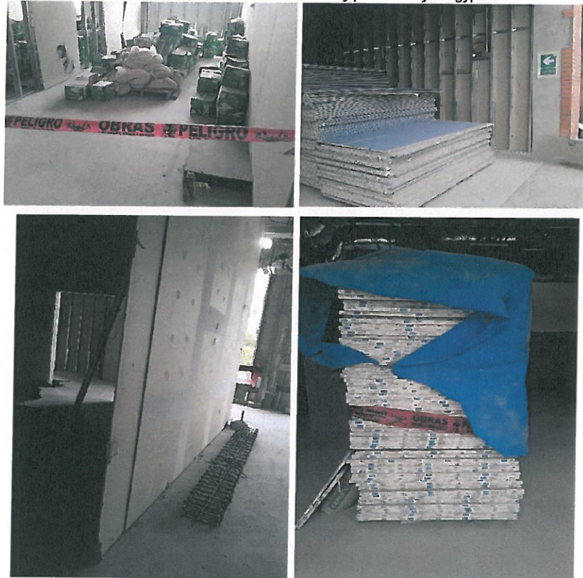
Imágenes n°08 Almacenamiento inadecuado de masilla y planchas drywall gyploc
