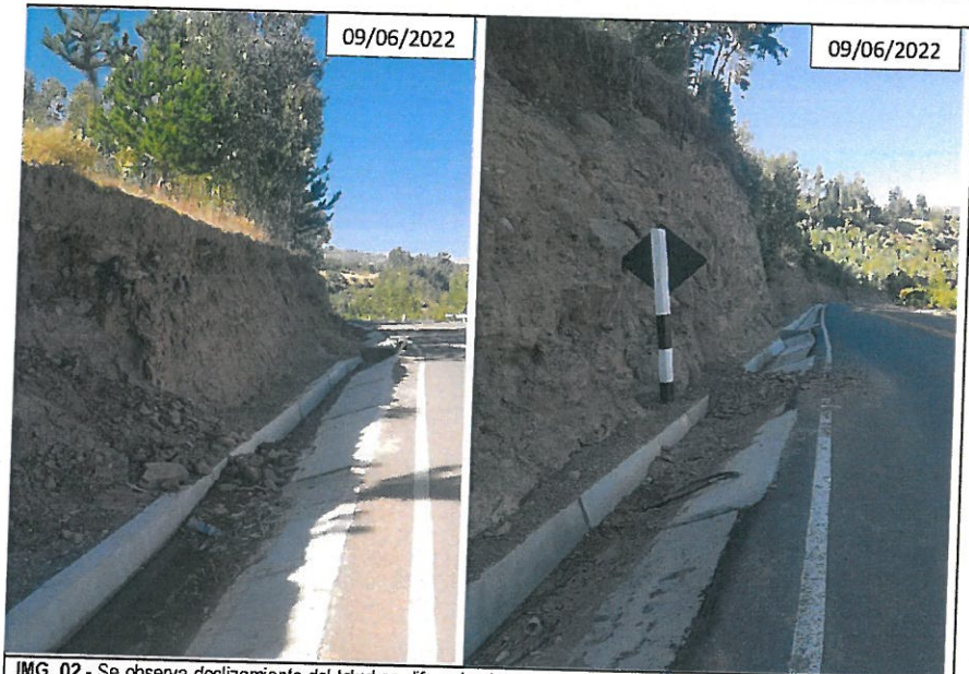
IMG. 02.- Se observa deslizamiento del talud en diferentes tramos a lo largo del Km 05+060 al 08+320, obstruyendo las cunetas laterales, siendo necesario su limpieza y mantenimiento de forma periódica.
