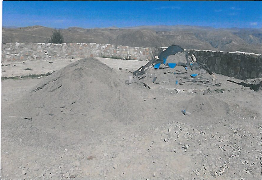
IMG. 08.- Se observa que los agregados no se manejan como materiales independientes, siendo estos contaminados con materiales extraños lo que podría modificar su uniformidad y características.
