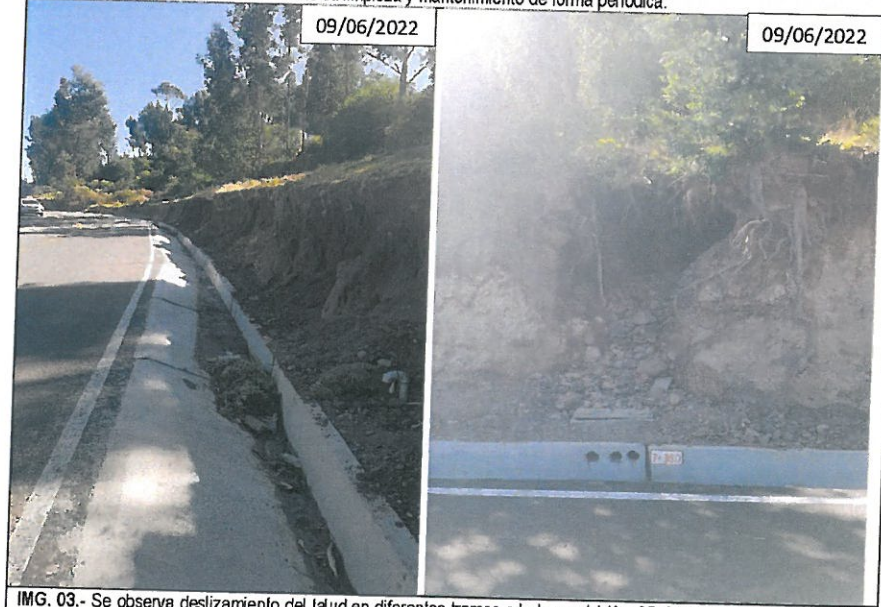
IMG. 03.- Se observa deslizamiento del talud en diferentes tramos a lo largo del Km 05+060 al 08+320, obstruyendo
