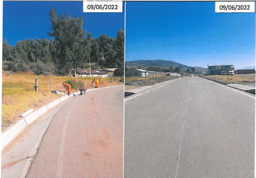
IMG. 07.- Se observa personal contratado por la Empresa Loaysa Contratistas Generales SRL, instalando postes delineadores. Además, de la intervención para el pintado de líneas laterales y central a lo largo del Km. 0+000 al 5+060.
