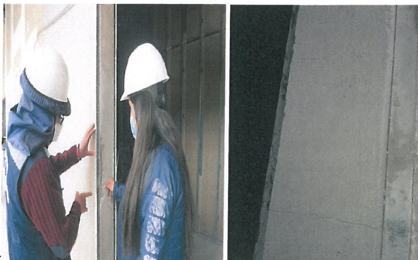
Imágenes n°06 Fisuras y desprendimiento de tarrajeo en derrame de ventanas
